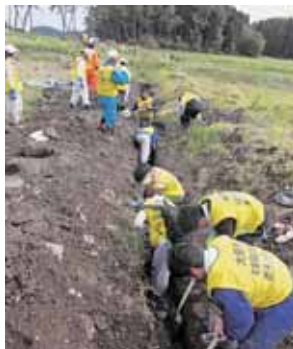
土砂やガレキを取り除きながら水路を掘り起こすボランティア。水路にたどり着くたび歓声があがる
